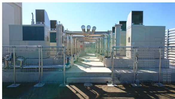
消化ガス発電施設
