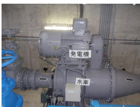
使用している発電機
